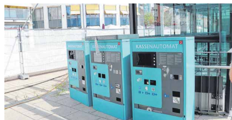
Nahezu alle elektronischen Geräte, die den Brand im Parkhaus am See überdauert haben, müssen erneuert werden.
